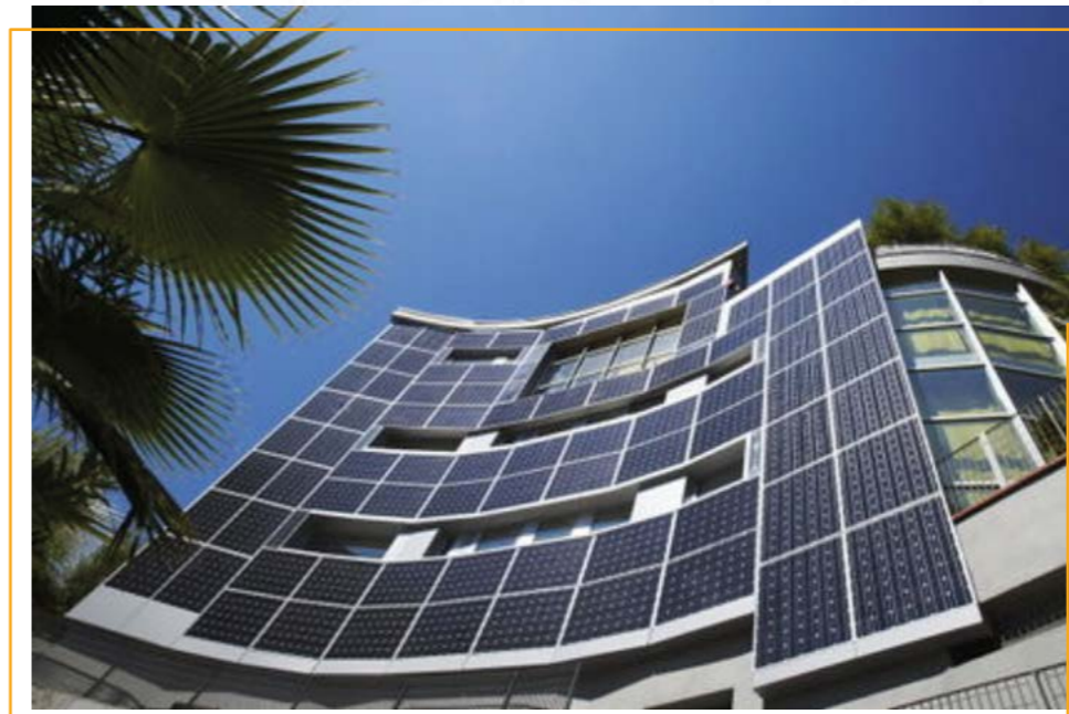
Figura 57. Integración fotovoltaica en edificios (BIPV)
